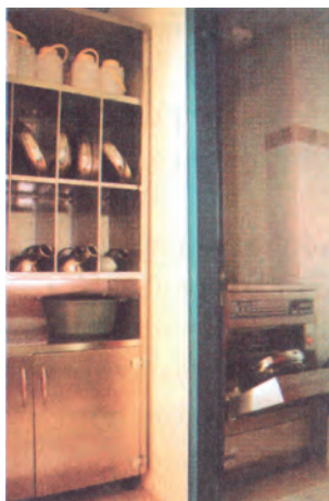
Εικ. 40 Πλυντήριο σκωραμίδων και ουροδοχείων.
